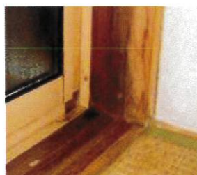
室内への雨漏り
